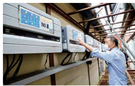
▲配電盤では、発電量などリアルタイムで随時確認可能
