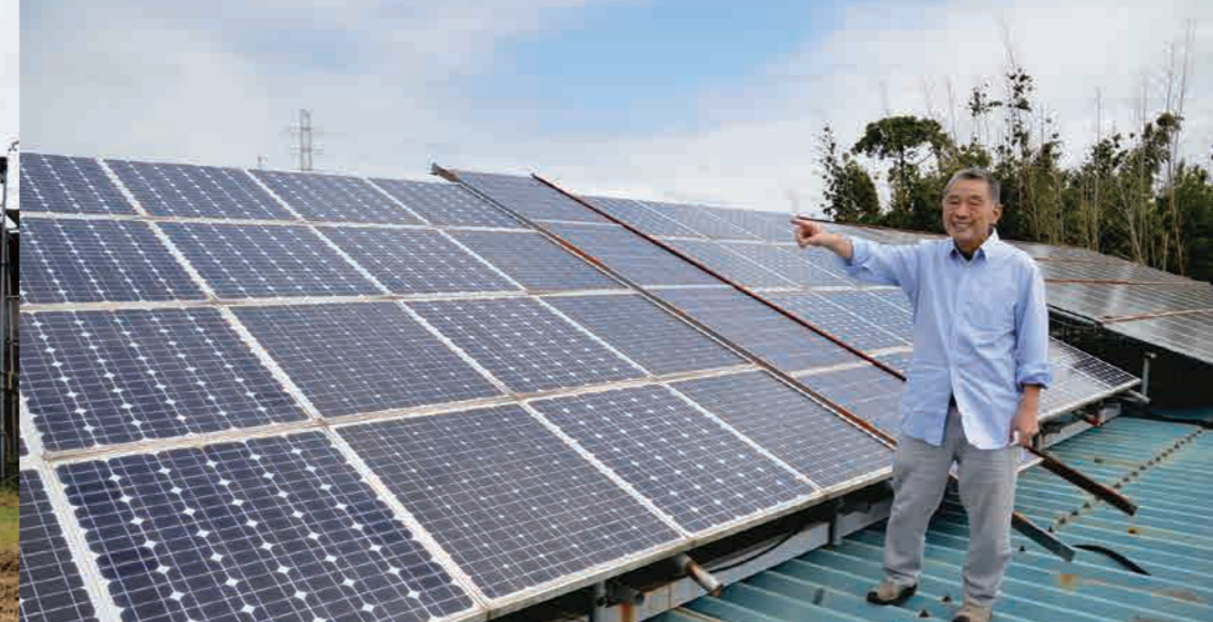
▲屋上の太陽光発電設備と前野社長。屋上一面に設置されたソーラーパネルは約800枚
