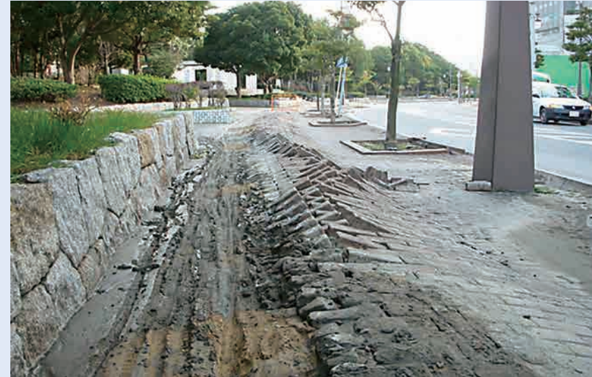
▲大きな揺れにより隆起・沈下した歩道（美浜区ひび野）（3月）【千葉市提供】
